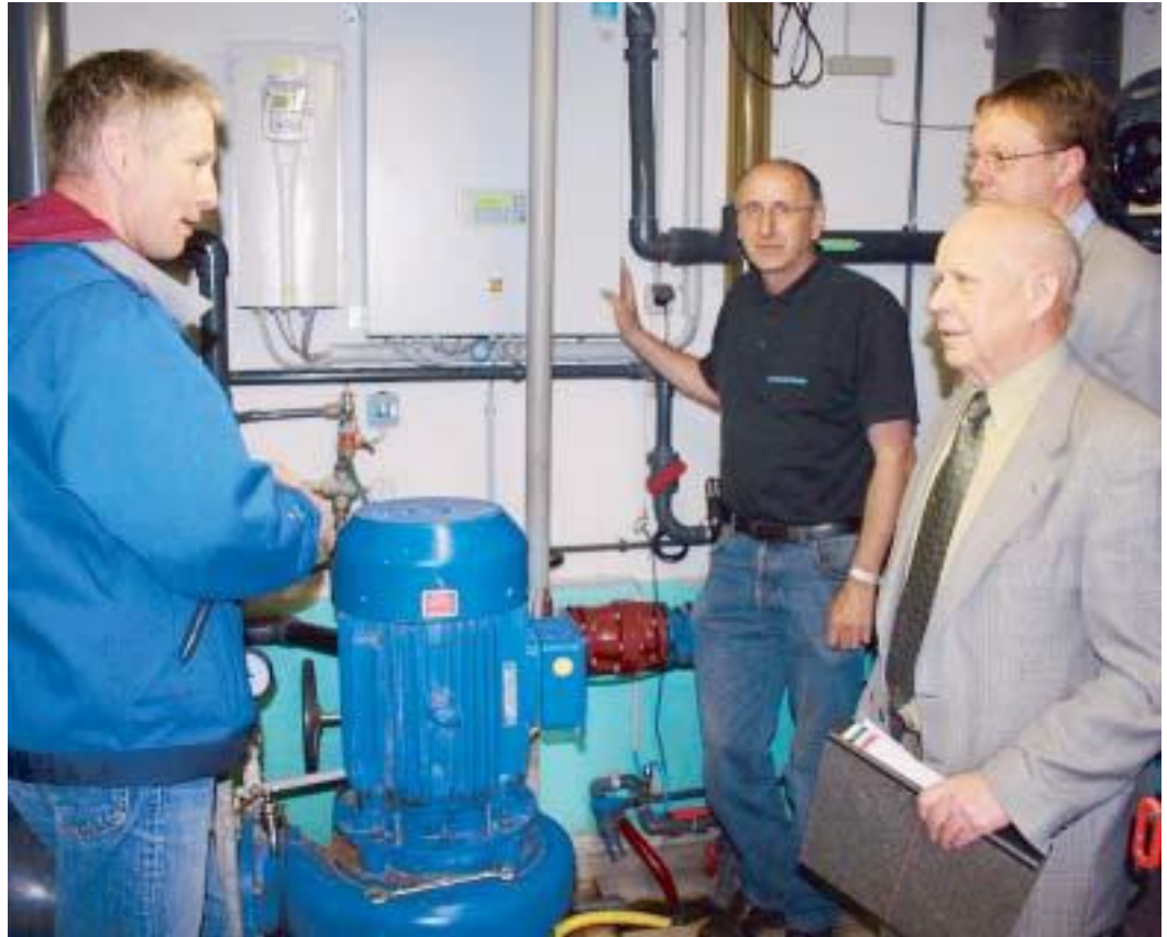
Schwimmeister Uwe Lämmel und Techniker Lutz Knoppe präsentierten den Bürgermeistern Meinen und Spiekermann (v.l.) die neue Technik im Erlebnisbad.
