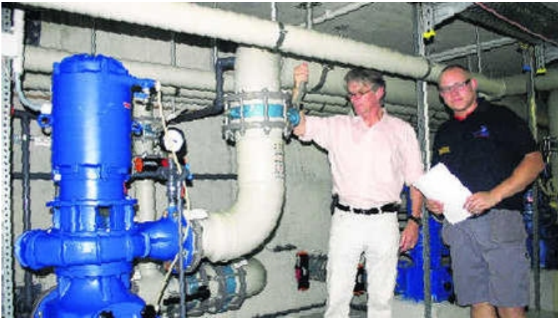
Betriebsleiter Peter Koop (links) und Technischer Leiter Christian Maier stellten das neue System vor.
